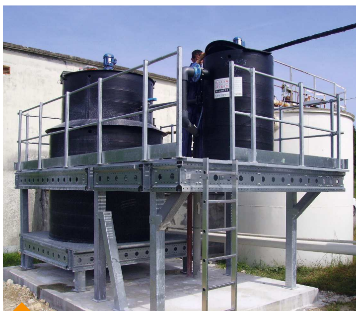
Plateforme de maintenance.
